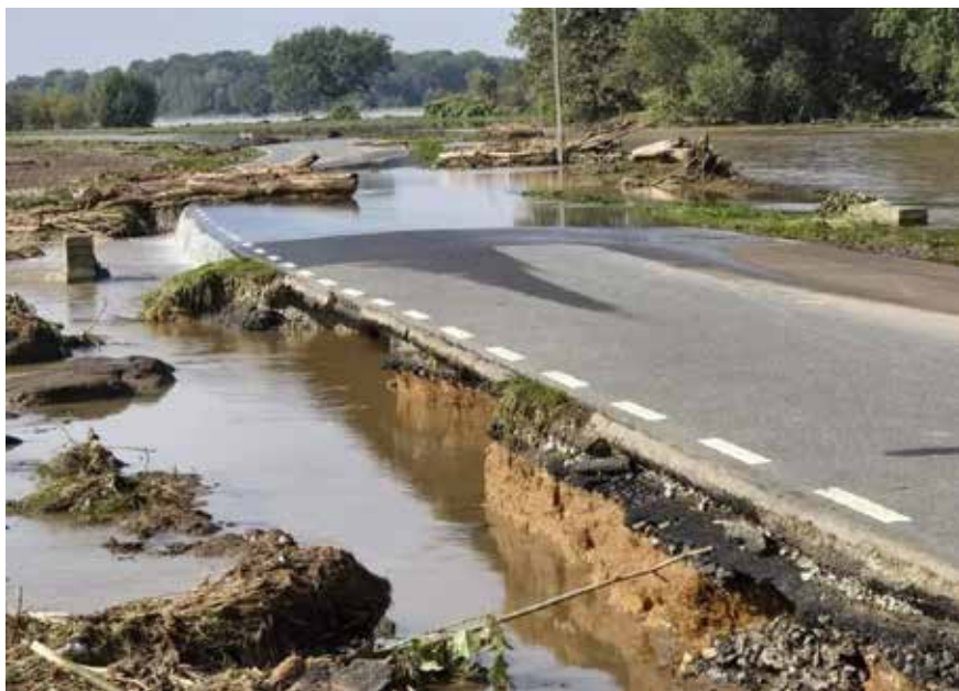
Zniszczona droga powiatowa na odcinku Gołaszycze-Śmiałowice
